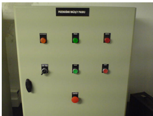
Szafka pomiarowo – sterownicza dla przenośnika MPW z motoreduktorem 0,37kW.
